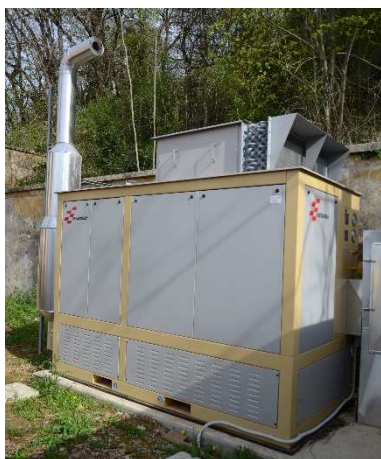
Impianto di microgenerazione presso Casa Anna Guglielmi
