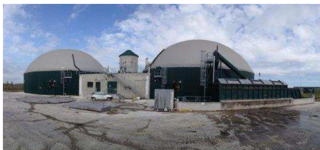
Impianto di produzione di energia elettrica a biomassa
