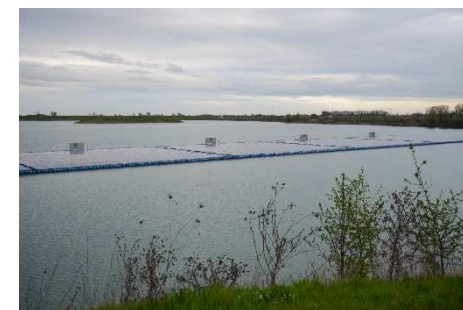
Impianto fotovoltaico galleggiante sito a Bubano
